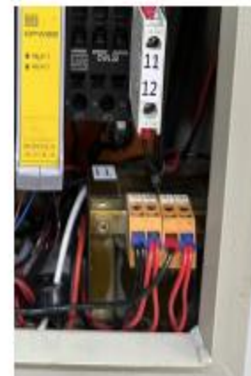
Transformador de 220V para 24VCA
